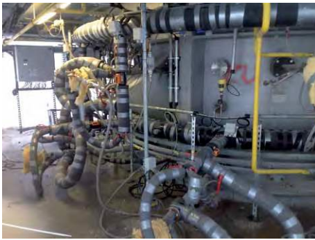
Bild 9: Brennerlanzen mit Steuerungstechnik
