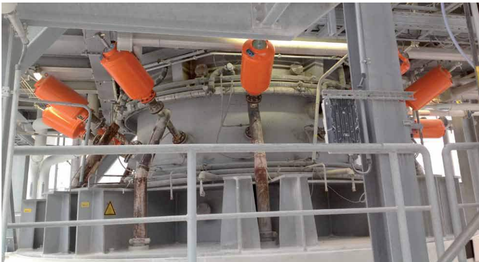
Bild 12: Luftkanonen im Bereich der Kühlluftabführung
